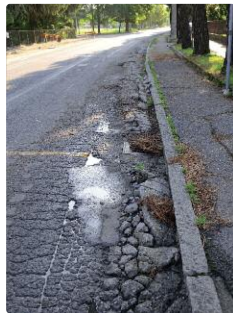
Un esempio dei danni provocati dalle radici dei pini in via Leonardo da Vinci, prima dell'intervento in corso.
