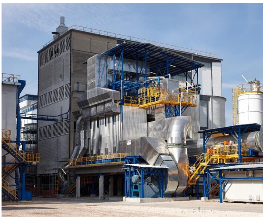
Figura 3.3- Nuovo impianto deSOx + deNOx + filtro a tessuto
